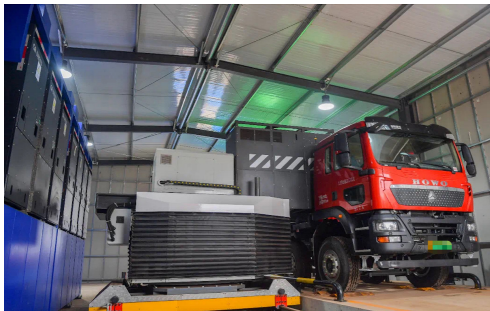
图 6-6 侧向换电实拍图——青港物流 001 号站
